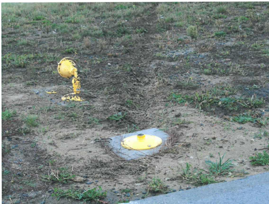
Fot.3 Uszkodzona lampa końca drogi startowej oraz ślad lewego koła podwozia głównego przy progu THR26.
