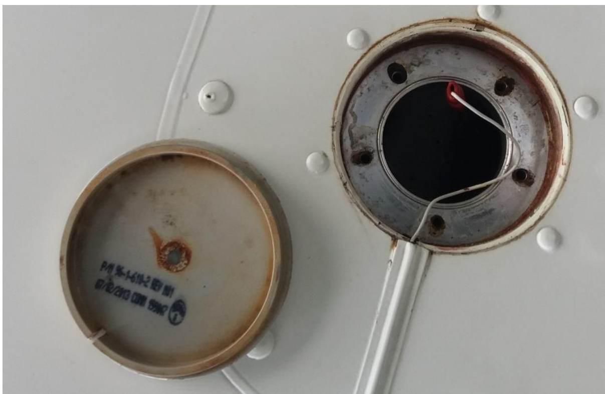
Rys. 14. Na zdjęciu pokazano zaślepkę i kołnierz do mocowania pływakowego wskaźnika paliwa lewego zbiornika. Widoczne ślady rdzy [źródło: PKBWL].
