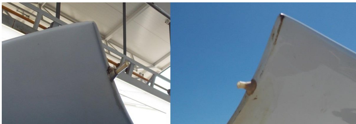
Rys. 17. Na zdjęciach pokazano sposób zamontowania odpowietrznika lewego i prawego zbiornika paliwa. Widoczne podgięcie prawego odpowietrznika do góry [źródło: PKBWL].
