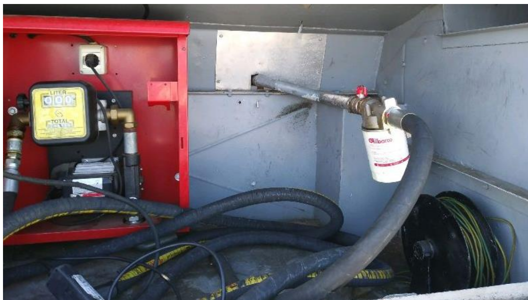
Rys. 6. Filtr paliwa zamontowany na kontenerowej stacji paliw.
