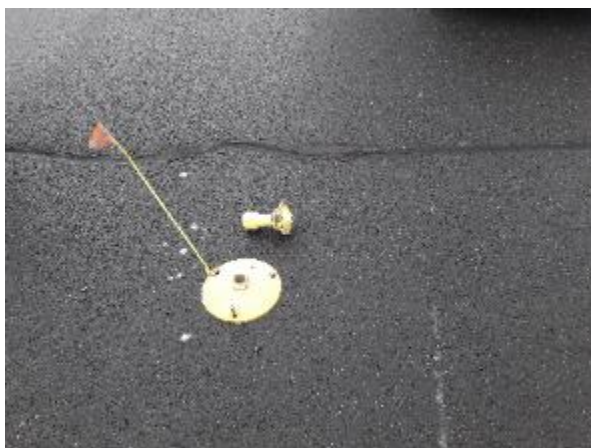
Rys. 3. Uszkodzone oświetlenie pasa
