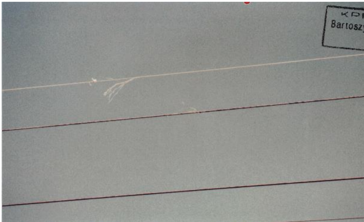
Rys. 2 - Uszkodzenia linii energetycznej (źródło: KPP w Bartoszycach)
