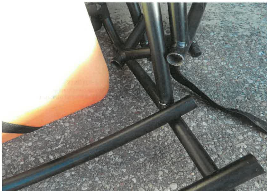
Rys.nr 4 uszkodzone elementy mocowania zespołu napędowego ( źródło PKBWL ).
