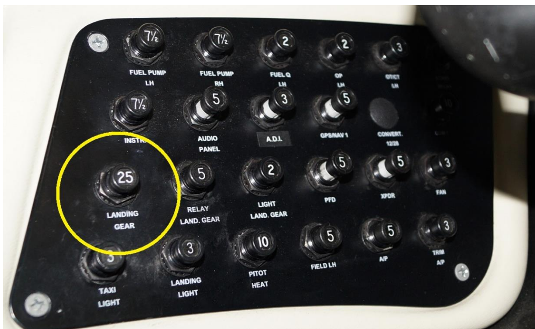
Rys. 8. Panel bezpieczników samolotu Tecnam P2006T zawierający bezpiecznik „ LANDING GEAR ” zabezpieczający obwód silnika pompy hydraulicznej układu chowania i wypuszczania podwozia [źródło: PKBWL]
