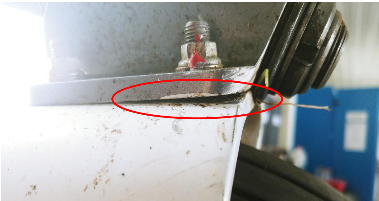
Rysunek 3. Odgięte widełki od konsoli w miejscu połączenia śrubowego.
