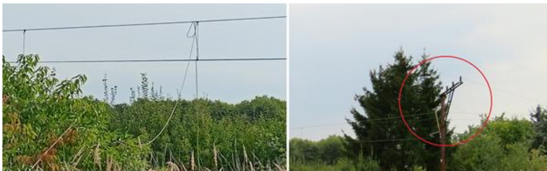
Rysunek 4. Uszkodzona trakcja elektryczna linii kolejowej [źródło: Aeroklub Zagłębia Miedziowego]
