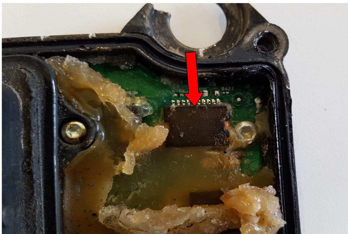
Fot.18. Część sterownika po usunięciu masy zabezpieczającej. Czerwona strzałką wskazano miejsca, w których przed wypadkiem przylutowane były elementy elektroniczne. (foto PKBWL).
