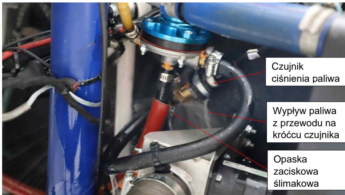
Rys. 3. Wypływ paliwa spod opaski ślimakowej mocującej przewód paliwowy do króćca czujnika ciśnienia paliwa. [źródło: PKBWL]
